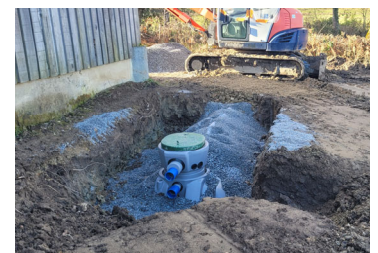
Cuve de 5000 L enterrée pour la récupération de l'eau de pluie du hangar
